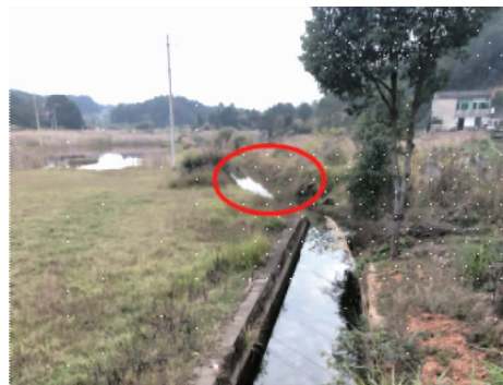
图 2 渠道局部垮塌下沉被水淹没
