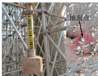
图7 支架沉降观测标杆尺
