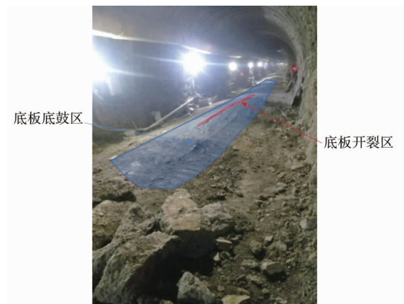
图 2 隧洞底板变形现场
