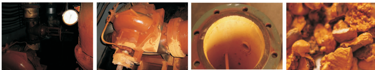
图2 HEMS降温系统的腐蚀现状
