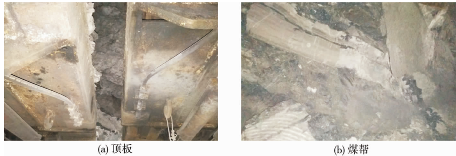
图4 工作面顶帮破坏情况
