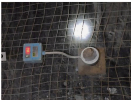
图6 锚杆测力计安装
