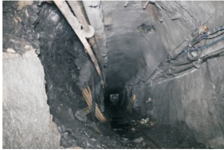
图4 返修后两帮出现严重内挤和垮塌
