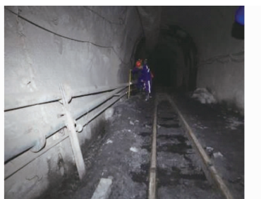
图 3 底板变形实物
