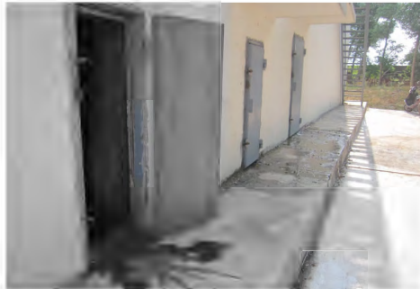
图 6 除尘装置前段流出的污水
