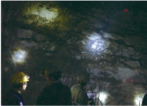
图1 采空区破碎岩体
